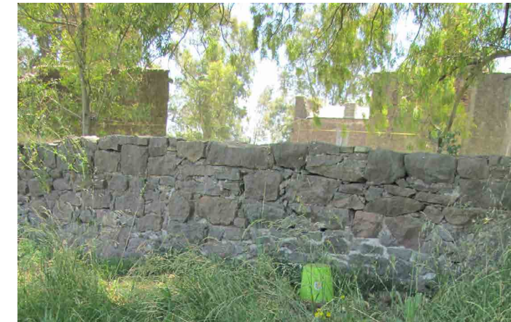
Figura 3. Fotografía que muestra un fragmento del muro perimetral de piedras semitrabajadas y calzadas con mortero de cal.
