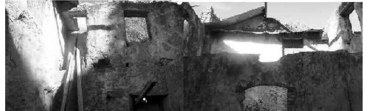
Figura 21. Deterioro en el último módulo construido.
